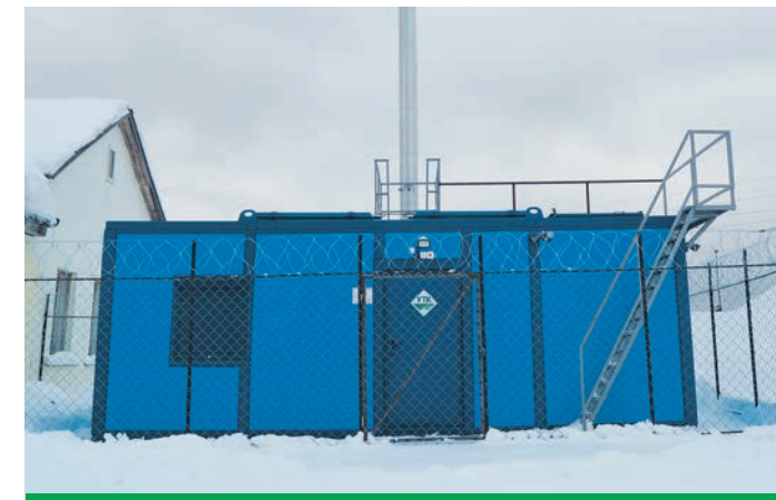
Модульная автоматизированная котельная в п. Костылево
